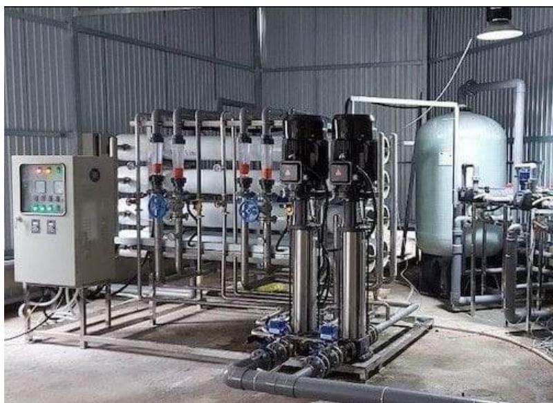
HỆ THỐNG LỌC NƯỚC RO CÔNG SUẤT: 20M3/GIỜ
