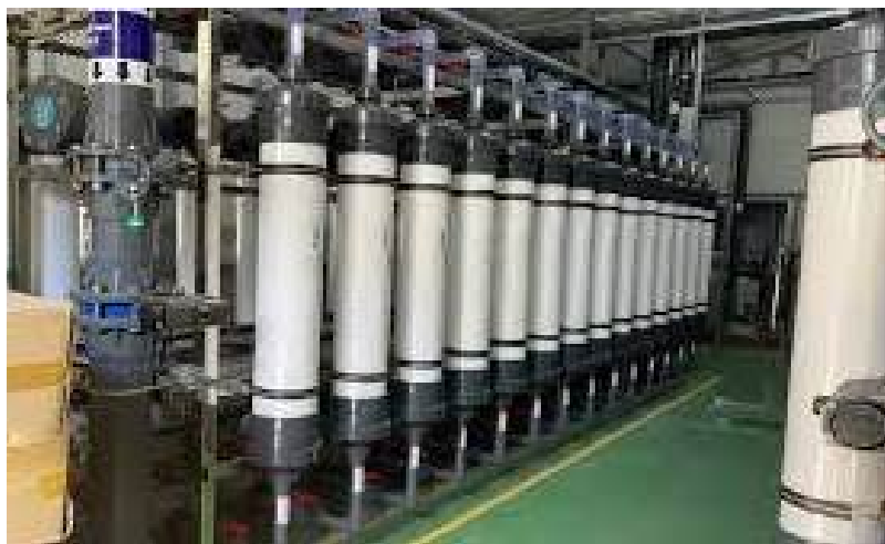
HỆ THỐNG LỌC NƯỚC UF CÔNG SUẤT: 50M3/GIỜ
